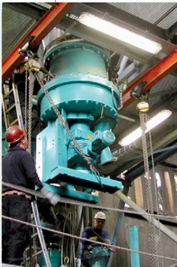
Dosage de charbon broyé en zone ATEX
